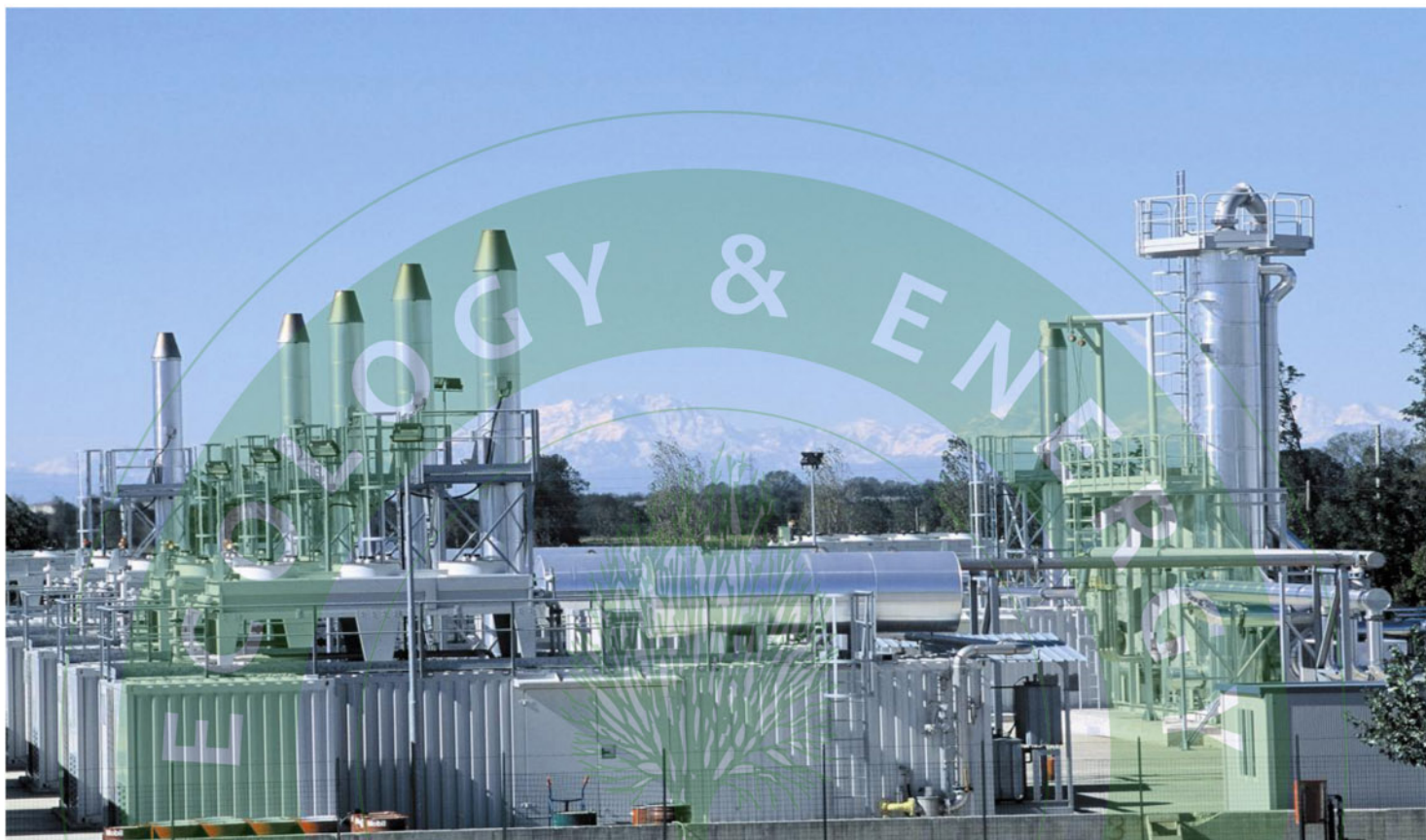
Centrale bioélectrique d'Inzago (MI) Puissance installée au démarrage: 6,4 MW
